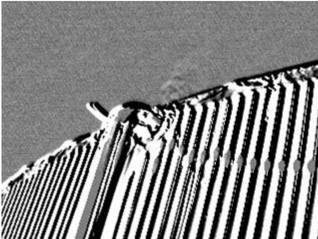
Abbildung 1: Undichtigkeit an einem Flansch
